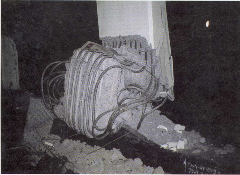
写真-22 神戸市兵庫区・阪神高速東西線大開 駅
