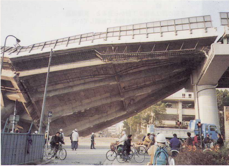
写真-100 神戸市東灘区・阪神高速道路3号神戸線 倒壊した高速道路の最東端を南側の深江南町1丁目から見た。
