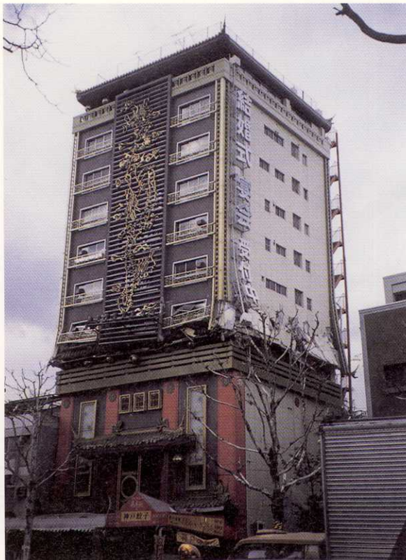
写真-66 神戸市中央区中山手通2丁目 構造様式の変わる中間階が押し潰され、壁が 外側に膨み出していた。
