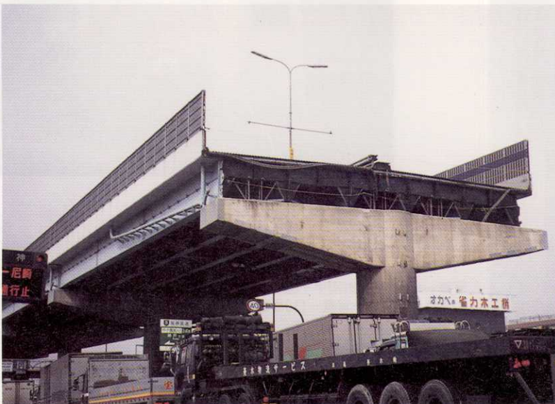
写真-117 西宮市久寿川町 阪神高速道路3号神戸線の橋桁が落下した。落下した橋桁は既に取り除かれていた（2月8日）。
