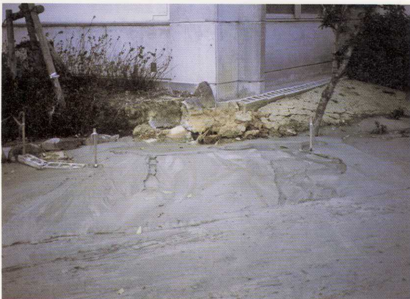
写真-118 西宮市浜甲子園4丁目・西宮今津高校 液状化により噴砂がいたるところで見られ、校舎が相対的に約20cm浮き上がっていた（採取番号-22）。
