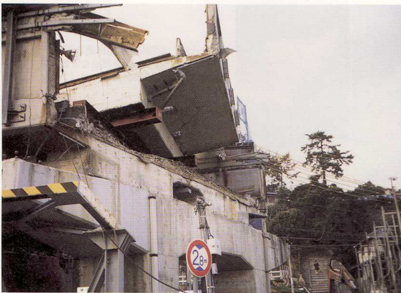
写真-123 西宮市松籟荘・JR山陽新幹線 落下した高架橋を取り除く作業が行われていた。また、丘陵地には崖崩れ防止のためにかけられた青いビニールシートが見える。
