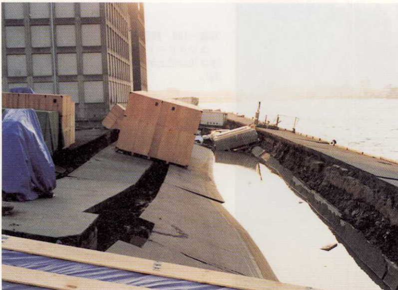
写真-105 神戸市東灘区深江浜町 ケーソン岸壁のエプロンが大きく陥没し、海 没していた（1月20日）。
