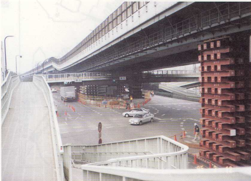
写真3 阪神高速道路神戸線高架橋の被害状況（神戸市東灘区深江交差点西側。橋脚の損壊のため桁が波打っている）
