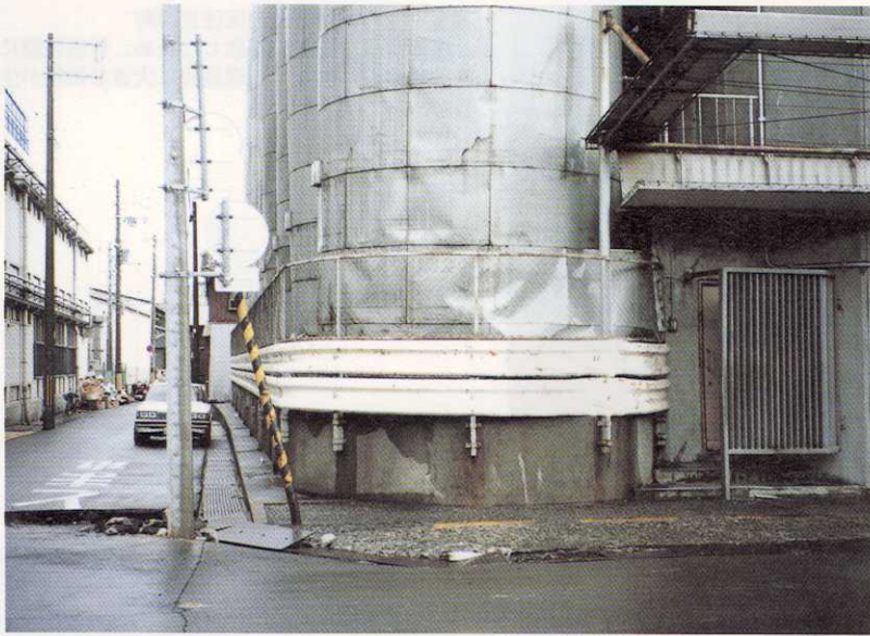
写真-79 神戸市東灘区御影本町3丁目 酒を入れるタンクの底部が破損したため、中に入っていた酒がもれていい臭いがしていた(2月5日)。
