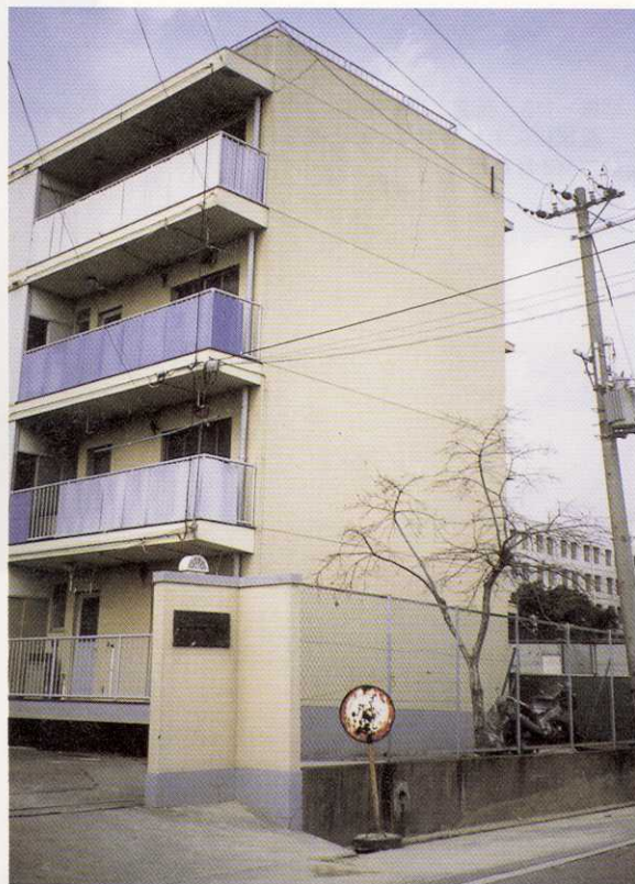
写真-119 西宮市南甲子園3丁目 液状化により、4階建ての公営住宅が不等沈下し、電柱が傾いた。
