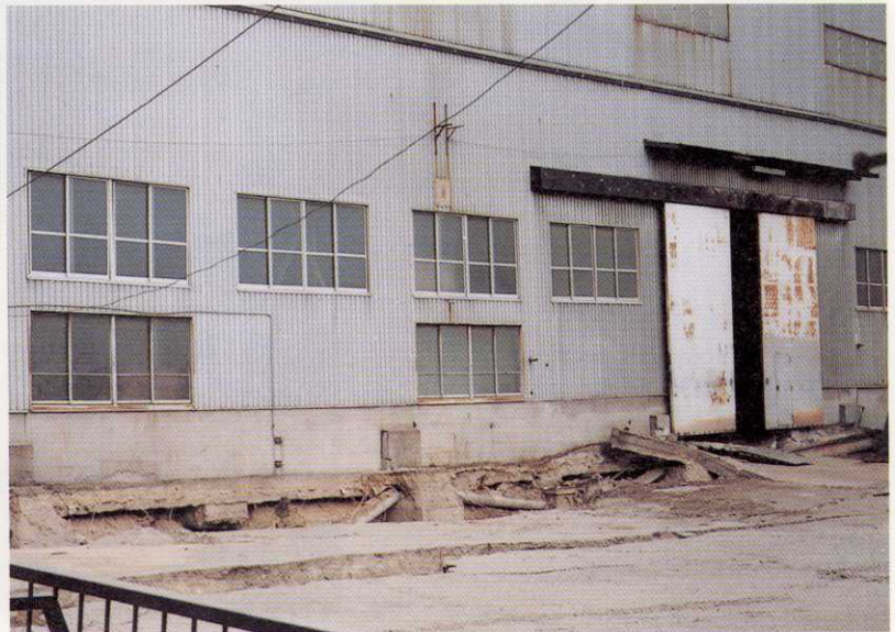
写真-89 神戸市東灘区魚崎南町3丁目 液状化により地盤が数10cm沈下したため、工場の基礎が相対的に浮き上がった。
