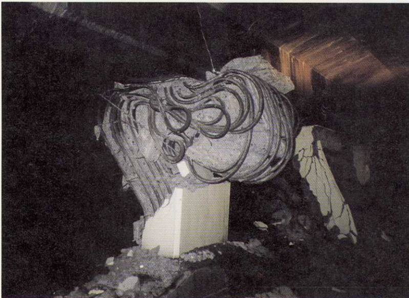
写真-24 神戸市兵庫区・阪神高速東西線大開 駅
