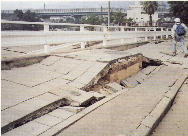
写真-102 神戸市東灘区深江南町4丁目 深江大橋に向かう取付け道路が数10cm沈下したため、コンクリート製の下水マスが相対的に浮き上がった。
