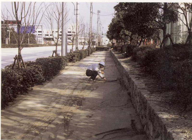
写真-87 神戸市東灘区向洋町中1丁目 六甲アイランド北部にある運動公園付近では、ほぼ全面的に液状化が生じており、いたる所で砂が噴き出していた（採取番号-16）。
