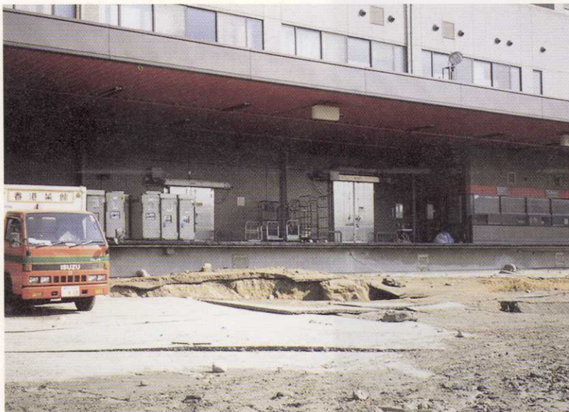
写真-36 神戸市中央区港島2丁目 トラック・ステーションでは地盤が液状化に伴って噴き出したため、舗装板が粉々になって飛散し、大きな穴ができていた。その周辺には飛び出した礫が散乱していた。
