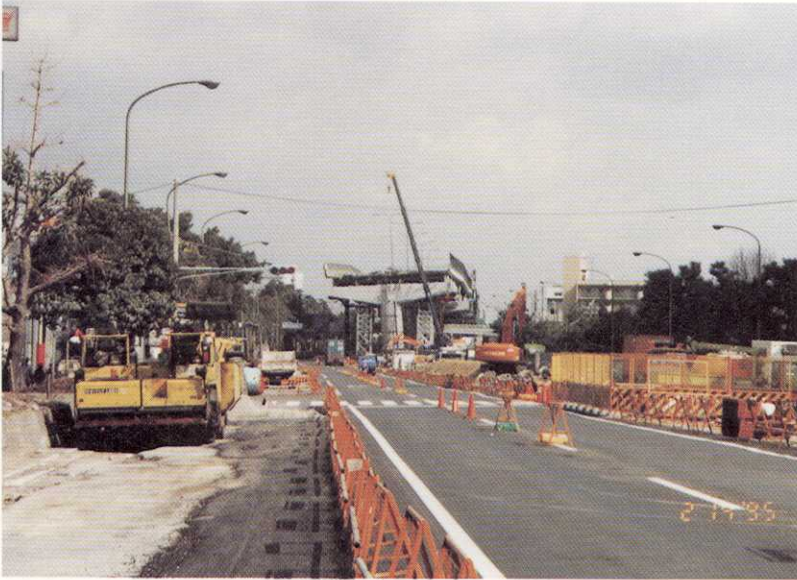
写真 7 阪神高速道路の倒壊現場
