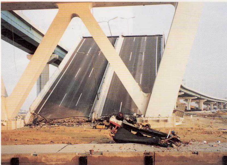
写真-114 西宮市甲子園浜・西宮港大橋 橋桁が落下したことにより、2台の自動車 が滑り落ちて転倒したため、運転手は死亡した。
