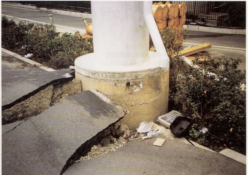
写真-110 西宮市西宮浜 支柱の浮き上がりを見ると、地盤は約40cm沈下したようである。
