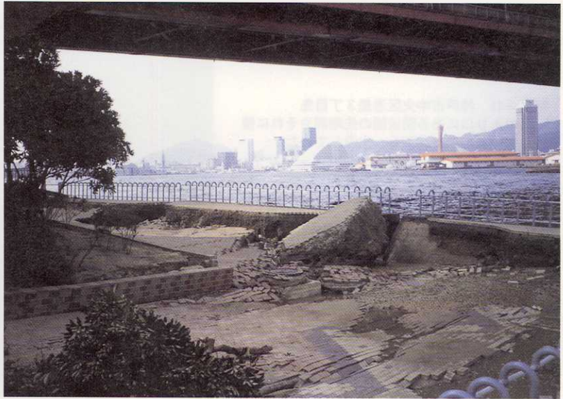
写真-38 神戸市中央区港島3丁目 ポートアイランド北公園では液状化によって地盤が崩壊し、護岸が膨み出した。背後の地盤は沈下したが、マンホールは浮上しなかった（1月20日）。
