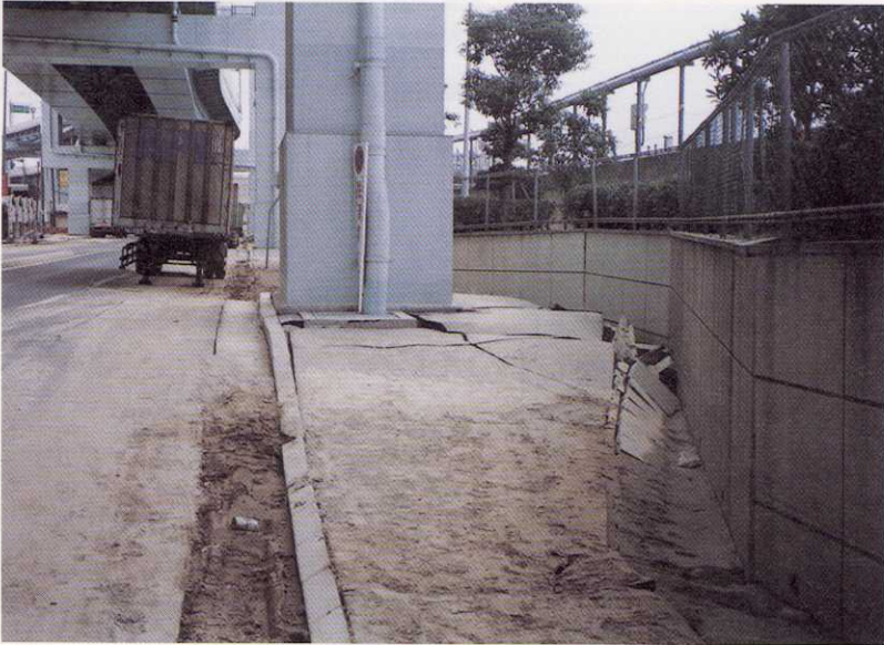
写真-91 神戸市東灘区魚崎浜町 大きな被害を生じた東灘下水処理場の前の道路でも液状化が生じていた（2月5日）。
