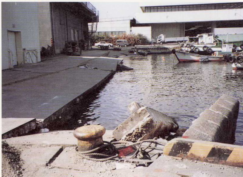
写真-30 神戸市兵庫区築地町・兵庫港 港管理事務所付近の岸壁が崩壊し、エプロン 部が海没した。
