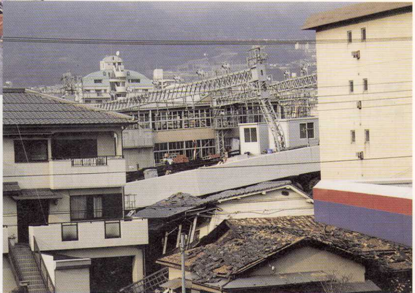
写真-74 神戸市東灘区御影塚町4丁目 高架の阪神電鉄石屋川車庫では、桁が落ちその下にあった住宅の屋根の上に載っていた(2月5日)。
