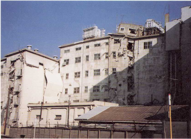
写真-28 神戸市兵庫区明和通2丁目 もろくも崩れた製粉工場裏側の状況である。
