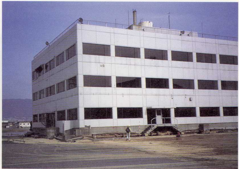
写真-32 神戸市中央区港島1丁目 地盤が全面的に数10cm沈下したため、杭基礎 の建物が相対的に浮上した。泥水が建物に付着 しておらず、噴き出した泥水の高さはせいぜい 30cm位と思われる。
