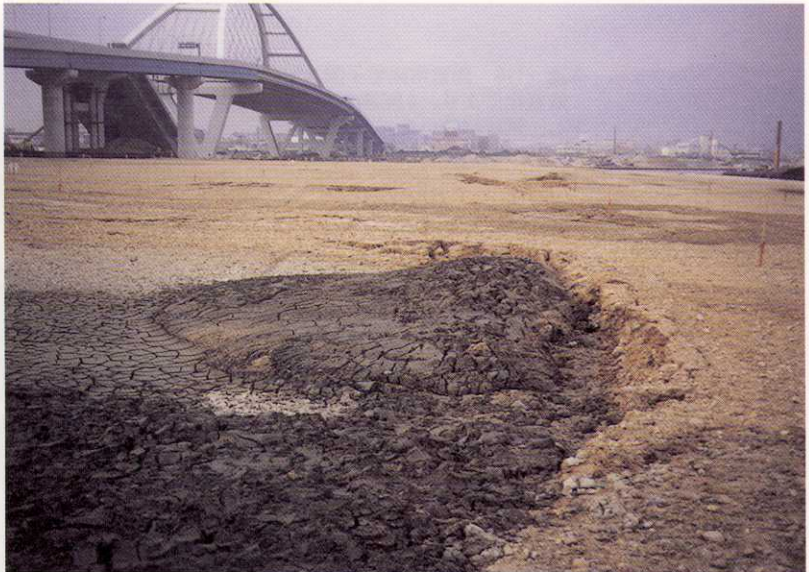
写真-116 西宮市甲子園浜 液状化によりヘドロが砂と共に地表に飛び出した（2月8日）。
