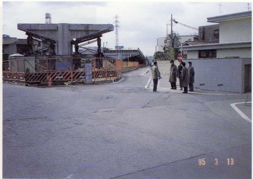
写真11 国道171号線の落橋現場（阪急電鉄今津線門戸厄神駅南側 門戸高架橋）
