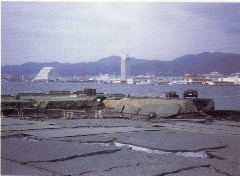
写真-33 神戸市中央区港島2丁目 岸壁の一部を残して激しく沈下したため、背 後のエプロン部が海没していた。高低差は2m以 上に達していた（1月20日）。
