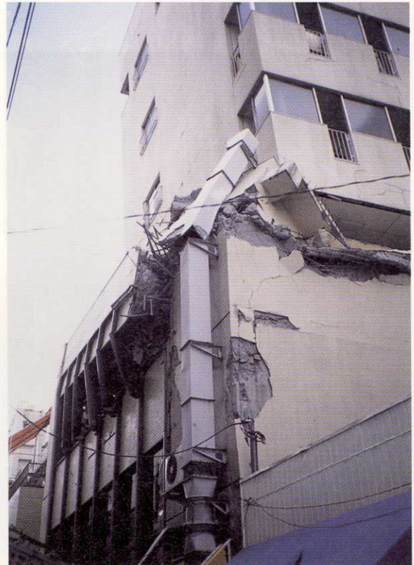
写真-65 神戸市中央区下山手通1丁目 構造様式の変わる中間階が押し潰され、上部 階が左側に傾いた。
