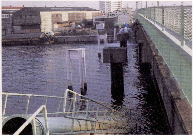
写真-104 神戸市東灘区深江浜町・深江大橋 深江大橋の脇を通る送水管が落下したため、 水が勢いよく噴き出していた。
