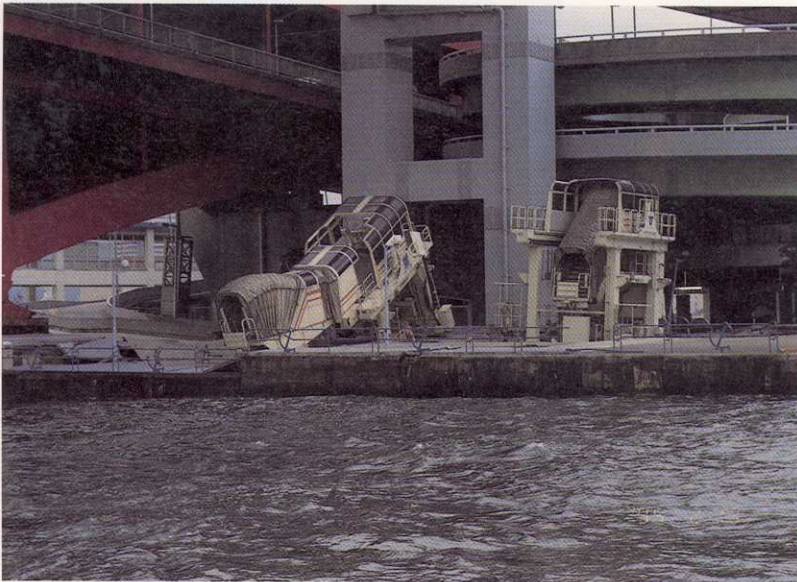
写真-7 神戸港 神戸大橋下 港湾施設損壊
