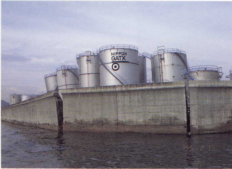
写真-13 長田港 岸壁損壊
