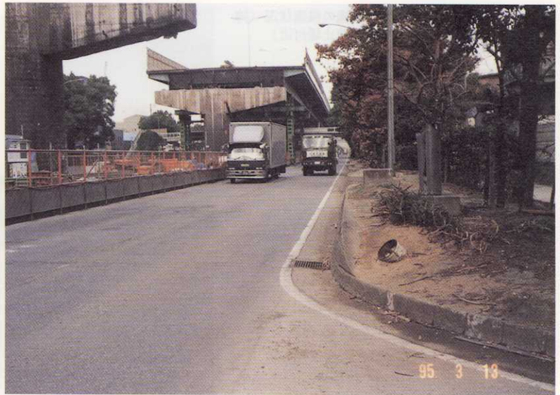
写真5 阪神高速道路神戸線の落橋区間の桁の 撤去後の状況 (西宮市浜脇町付近)
