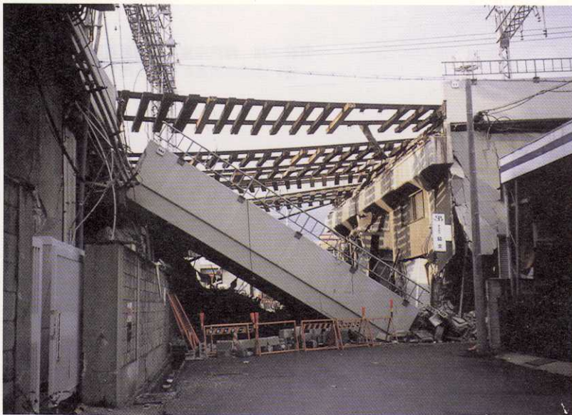
写真-75 神戸市東灘区御影塚町4丁目 阪神電鉄の高架橋が落下して線路が宙ぶらりんとなった。
