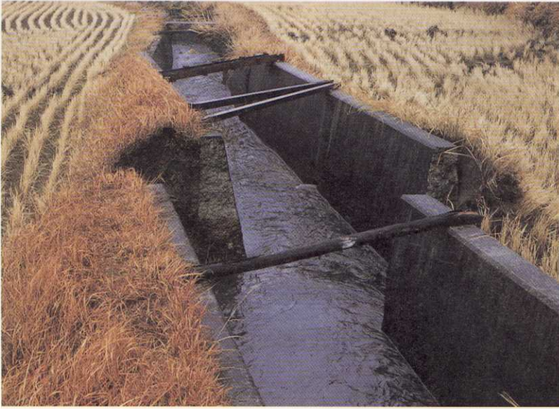
写真-10 北淡町梨本・野島断層 活断層によって水路が約1m右にずれたにもかかわらず水が流れていた(1月22日)。
