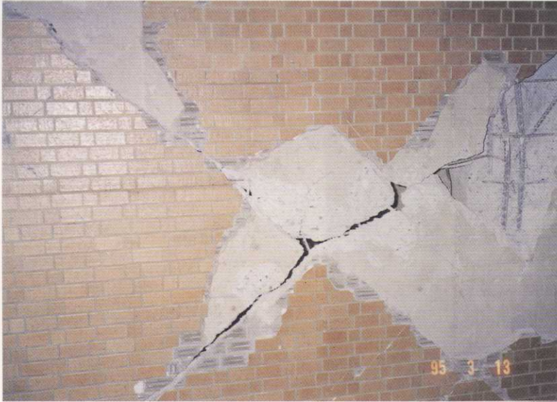
写真13 西宮市役所庁舎内部の損壊状況
