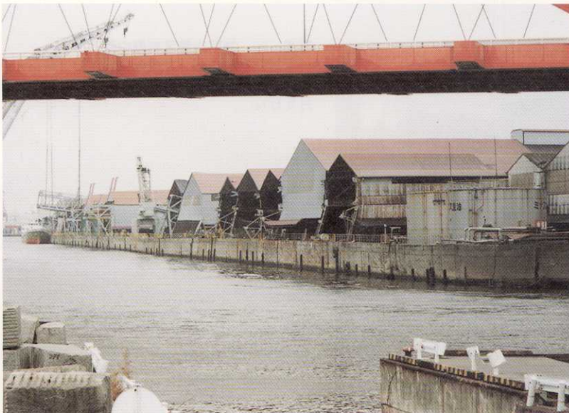
写真-72 神戸市灘区灘浜東町 岸壁が海側に膨み出して不同沈下していた。工場の鉄骨の柱も基礎が海側に移動したため、傾斜していた。
