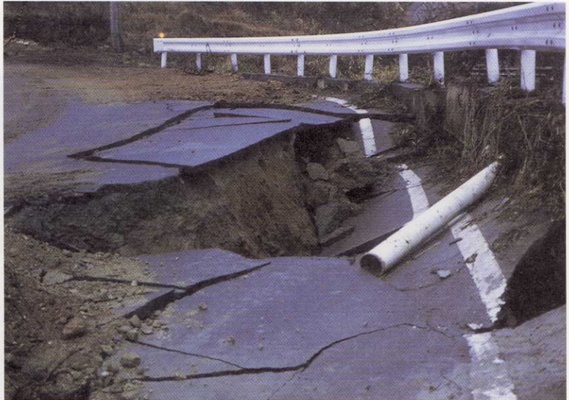
写真-11 北淡町野島平林・野島断層 斜面上にある舗装道路が低地側に膨み出し陥没していた(1月22日)。
