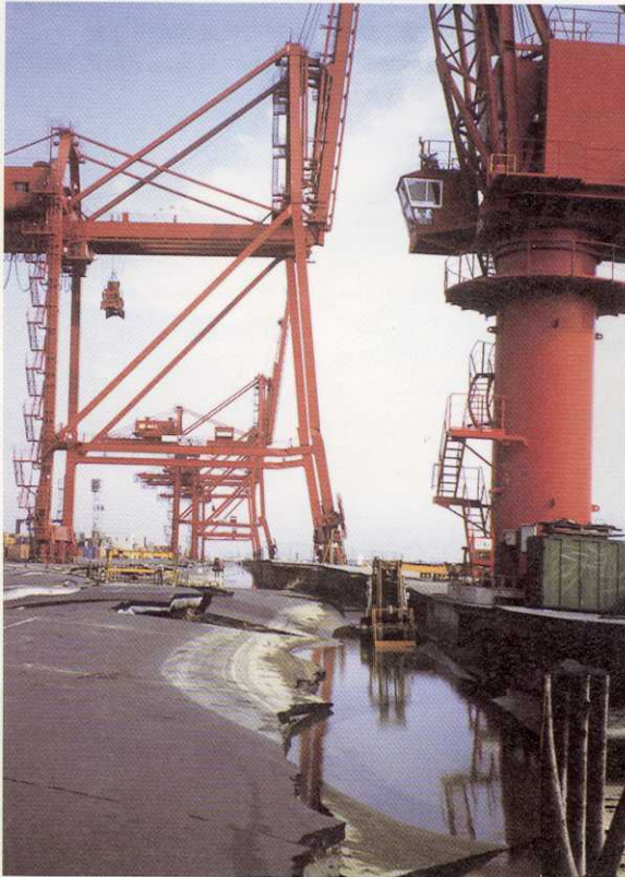
写真-85 神戸市東灘区向洋町東 六甲アイランド南東部にある岸壁の背後地盤が2m以上沈下したため、一部海没した。また、鋼鉄製の荷揚げ機械は不同沈下により何れも脚部が座屈していた。
