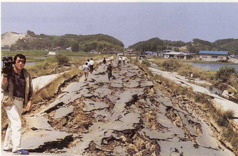
写真-L6 秋田県大潟村五明光橋・1983年日本海中部地震 八郎潟干拓地から若美町五明光に通じる五明光橋の取付け道路が液状化によってずたずたに破壊し、沈下した。
