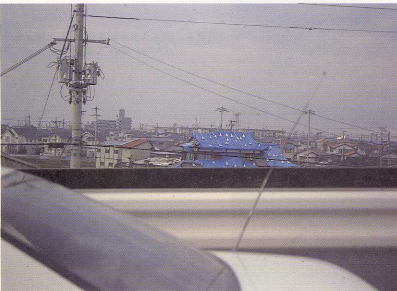
写真3 屋根の瓦が落ち、ビニールで補修 (明石市)
