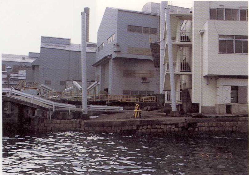
写真-5 神戸港 中央区弁天町 岸壁・道路・建物等損壊
