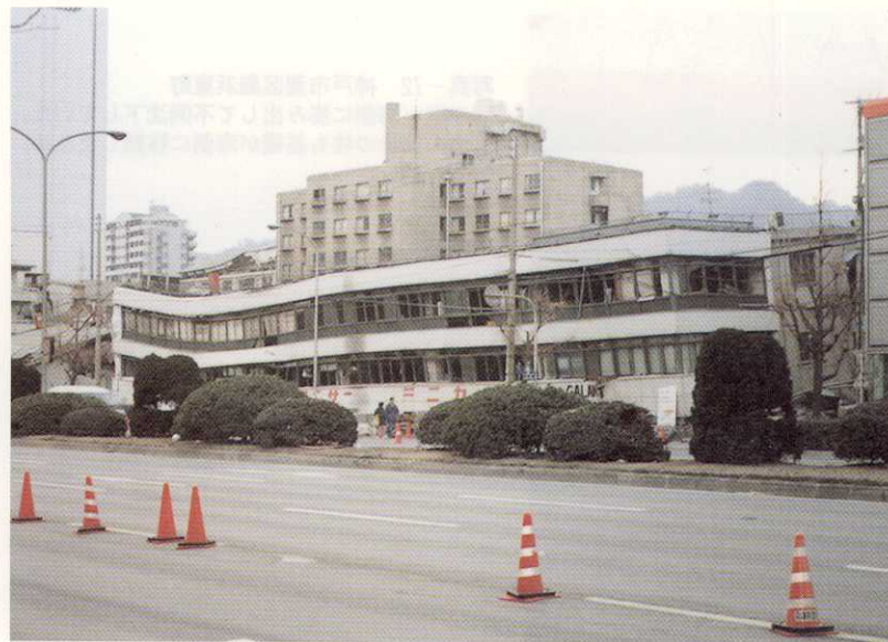
写真-69 神戸市灘区岩屋中町 国道43号線に面した自動車会社の1階ショールームが押し潰されるように破壊していた(2月5日)。
