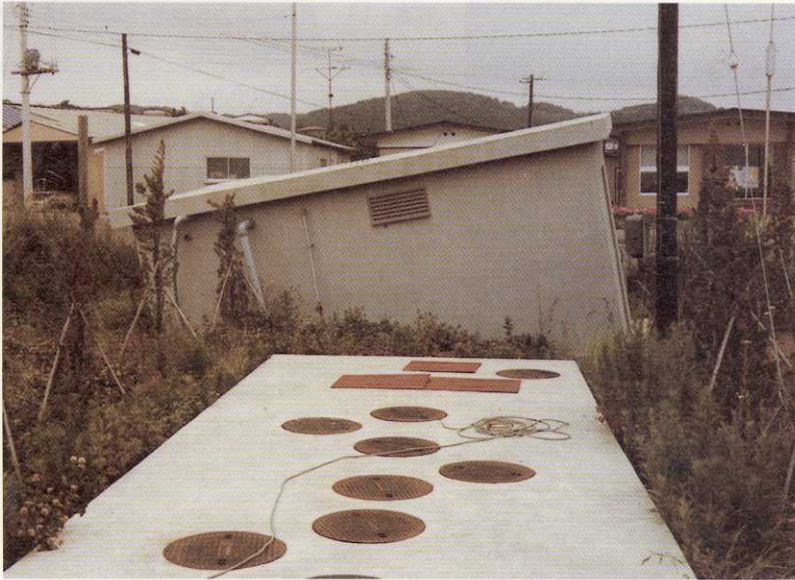
写真-L4 宮城県松島町高城・1978年宮城県沖地震 ポンプ室が液状化によって不等沈下し、約10°も傾いた。
