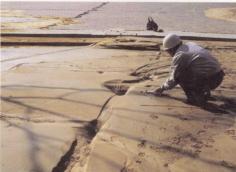
写真-39 神戸市中央区港島3丁目 北公園の神戸大橋直下で地盤の亀裂から液状化した砂が噴き出していた。亀裂と直角方向に細長く試料を採取しているところである（採取番号-1）。
