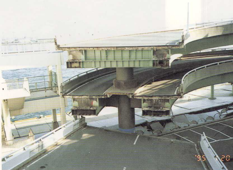
写真-51 神戸市中央区新港町・新港第四突堤 ポートターミナル付近にあるループ橋の橋 桁の一部が上下2段とも落下していた。
