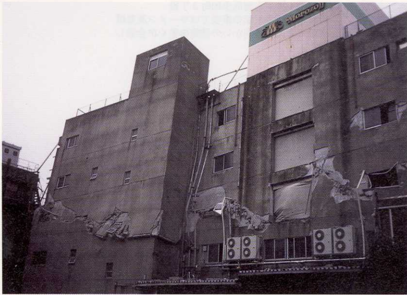
写真-76 神戸市東灘区御影塚町1丁目 菓子工場の3階が破壊していた(2月5日)。
