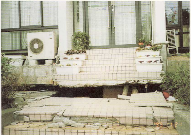
写真-107 神戸市東灘区深江浜町 埋立て地盤が数10cm沈下したため、郵便局の建物が相対的に浮き上がった。
