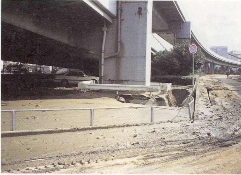
写真-37 神戸市中央区港島2丁目 神戸大橋から南下する高架道路の橋脚脇の地盤が液状化に伴って噴き出したため、大きな穴ができていた。周辺には飛び出した礫が散乱していた。
