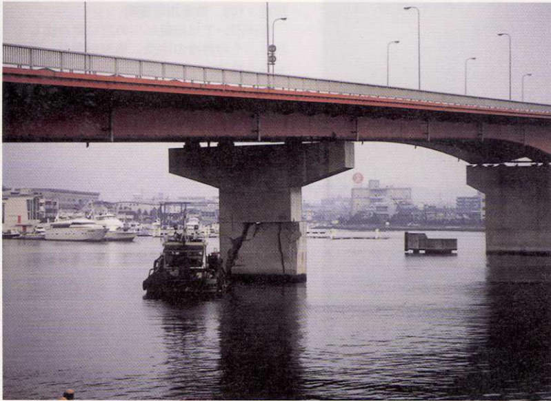
写真-112 西宮市西宮浜・西宮大橋 橋脚の下部が破壊したため、通行できなくなっていた。
