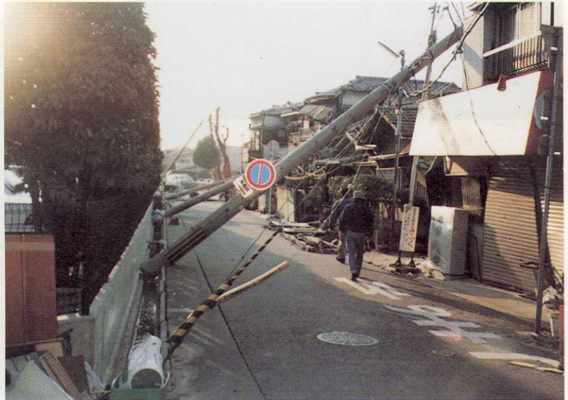
写真-101 神戸市東灘区深江南町3丁目 国道43号の南側の道路脇にある電柱が軒並み転倒し、民家に倒れかかっていた（1月20日）。
