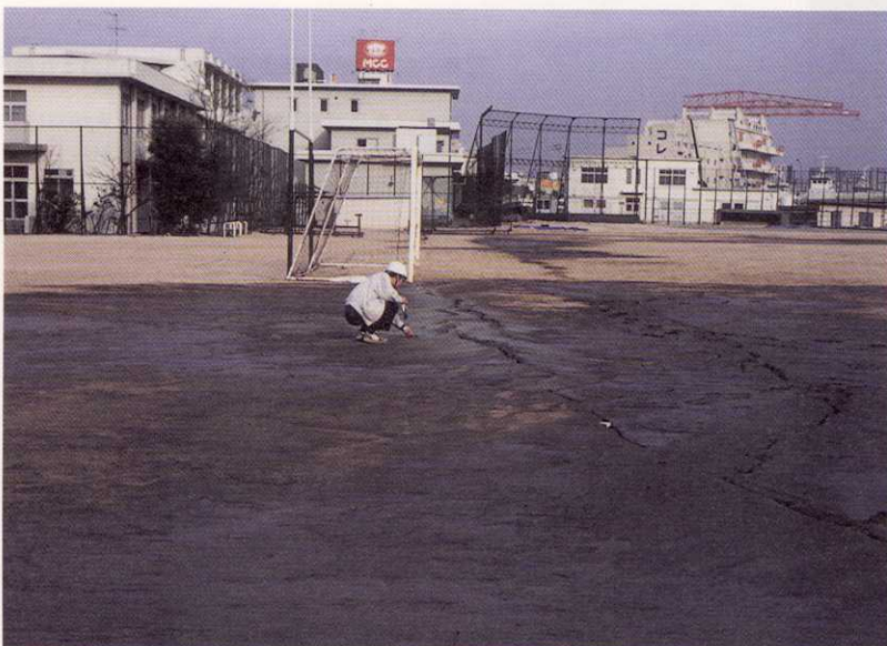
写真-93 神戸市東灘区深江南5丁目・神戸商船大学 グラウンドには亀裂が走り、砂が噴き出していた（採取番号-21）。
