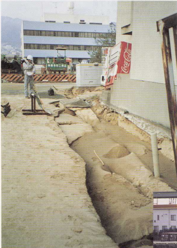
写真-70 神戸市灘区灘浜町 建物の脇に開口亀裂が生じ、その中に噴砂が見られた（採取番号-31）。
