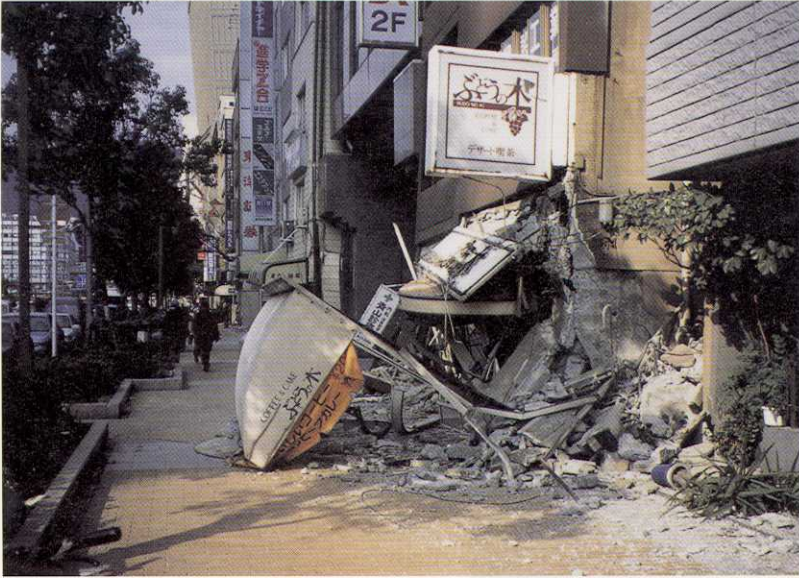
写真-55 神戸市中央区八幡通4丁目 隣の建物とは対照的に、1階の喫茶店がもろくも崩れた。その先にも、壊れたビル（写真-59、64）が見える。
