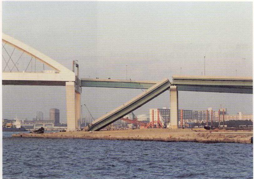
写真-113 西宮市甲子園浜・西宮港大橋 阪神高速道路湾岸線の甲子園浜側の橋脚が西側に移動したため、橋桁が落下した(1月20日)。
