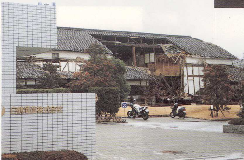
写真-81 神戸市東灘区住吉南町 伝統的な木造の酒蔵の中間部が壊れていた。
