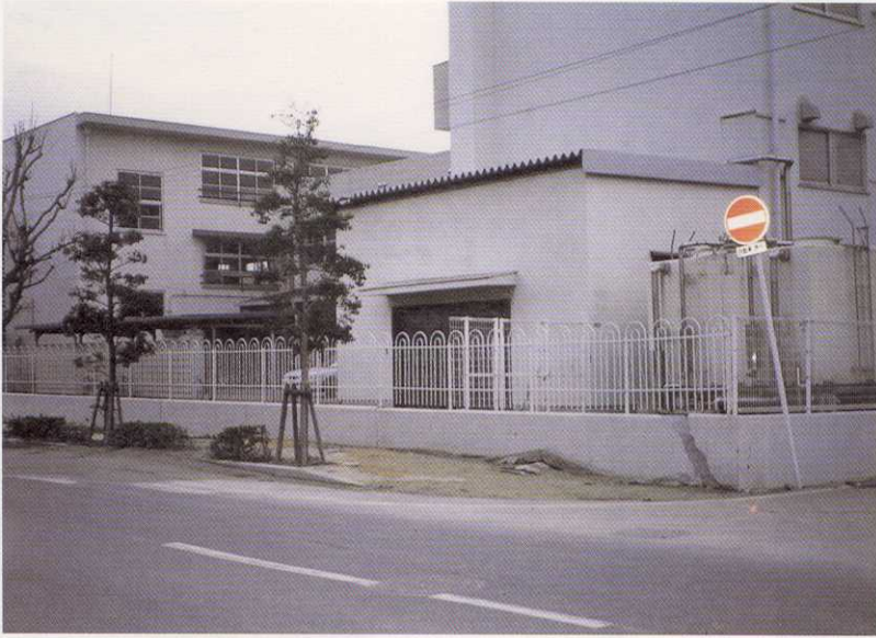
写真-121 西宮市南甲子園3丁目 液状化により、南甲子園小学校の塀が破損し、側溝が折れ曲がり、道路標識が傾斜するなどの被害が生じた（採取番号-23）。
