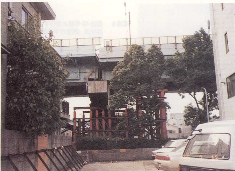
写真6 阪神高速道路神戸線の高架橋桁の損傷 状況 (西宮市浜脇町付近)
