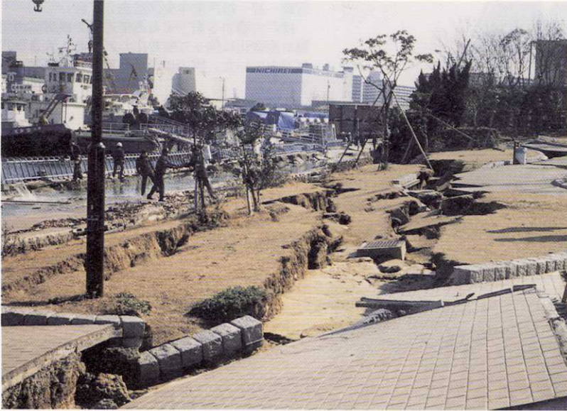
写真-40 神戸市中央区港島3丁目 北公園では液状化によって地盤が崩壊し、護岸が大きく膨み出したため、背後の遊歩道が亀裂を伴って沈下し、水没した。
