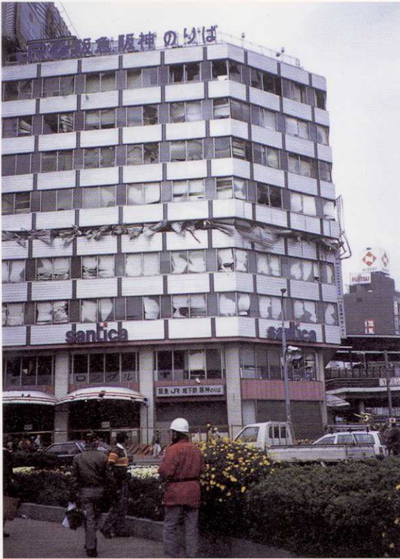
写真-64 神戸市中央区三宮町1丁目 9階建ての交通センタービルでは、中間の5階 部分が潰れていた（1月20日）。
