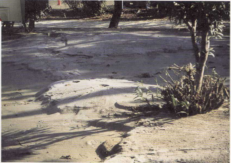
写真-26 神戸市兵庫区遠矢浜町・神戸検疫所 検疫所内のいたる所で噴砂が見られた。検疫所の細長い建物は若干不等沈下していた（採取番号-33）。
