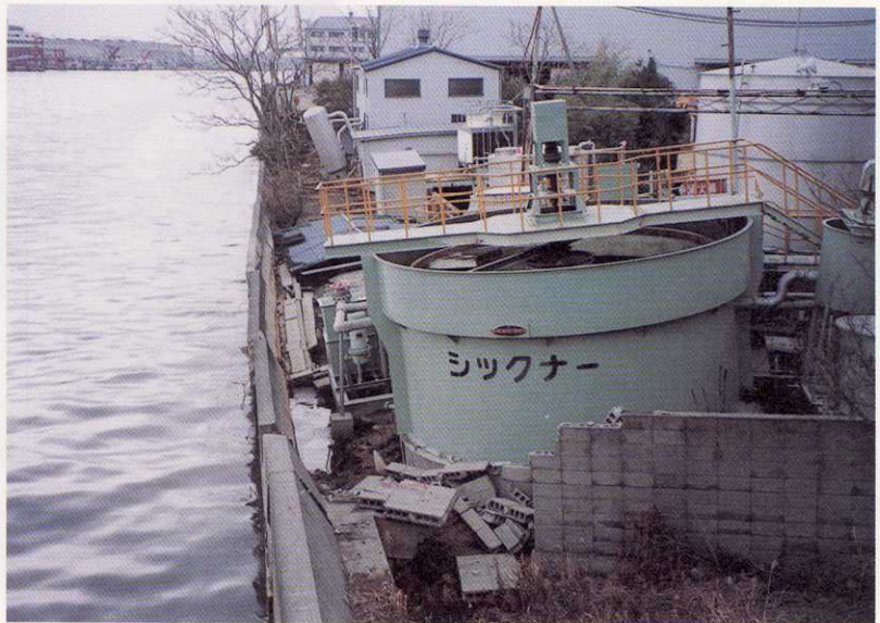
写真-92 神戸市東灘区魚崎浜町 岸壁の背後地盤が海側に沈下しながら移動したため、シクナータンクなどに被害が生じた。
