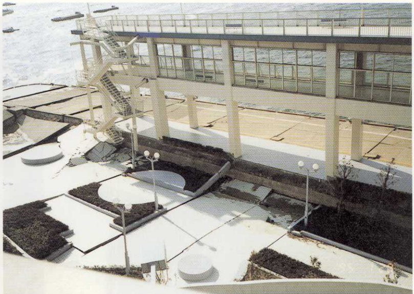
写真-50 神戸市中央区新港町・新港第四突堤 神戸大橋から見ると、突堤先端中央部の地盤 が約2m沈下していた。
