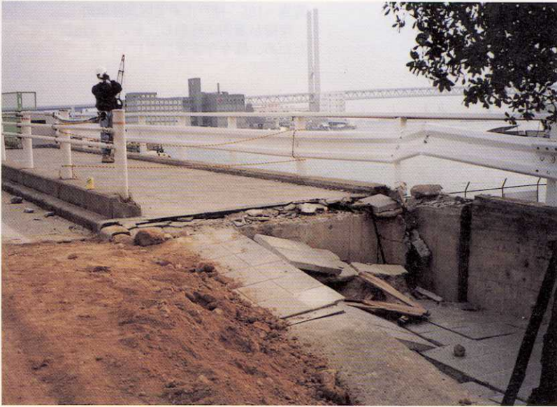
写真-103 神戸市東灘区深江南町4丁目 深江大橋の北側の取り付け部分が約70cm沈下した。
