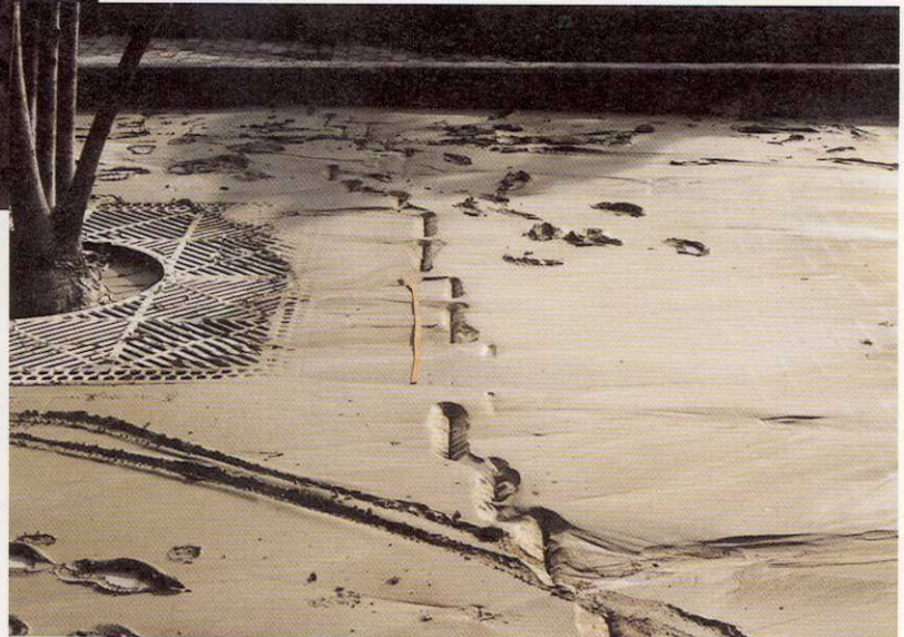
写真-86 神戸市東灘区向洋町中1丁目 シティヒルM13の公園は、周囲より1m以上高くなっているにも拘わらず、カラー敷石の間から液状化砂が噴き出していた（採取番号-15）。
