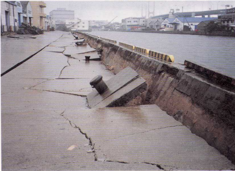
写真-88 神戸市東灘区魚崎南町5丁目 岸壁が海側に膨み出し、背後地盤が約1m沈下した(2月5日)。
