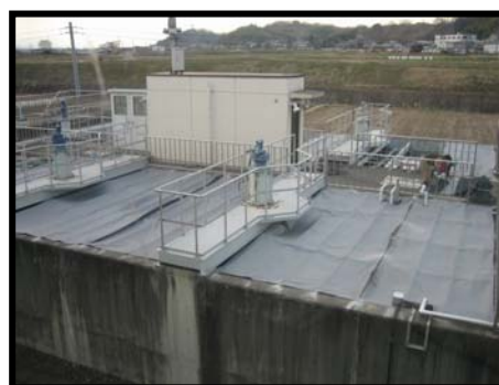
【高崎市 岩崎浄水場 ろ過池 覆蓋】
