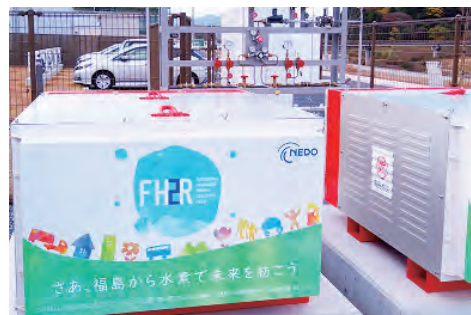
道の駅なみえに設置された純水素燃料電池システムの水素供給装置。太陽光発電により製造された水素により施設への電力供給を行う。
