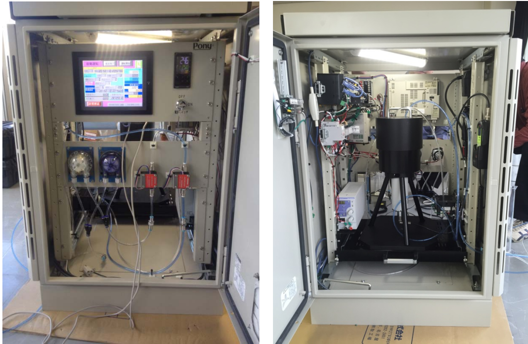
図 1.2-4 製作したモニタリング装置の外観
