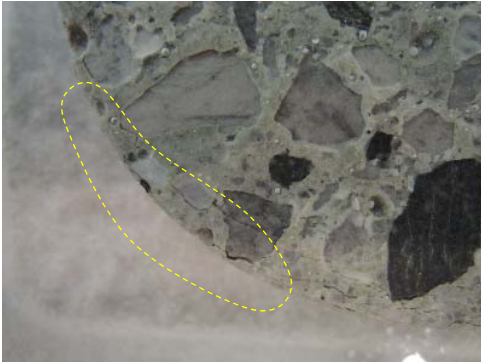
15-10-15 5°C : 周囲にひび割れペースト浮き
